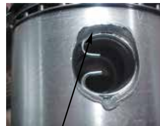
Fig. 1.1.3 Danos provocados pela trava
