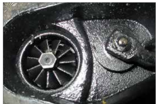
Fig. 13.4.4 – Óleo lubrificante na carcaça da turbina.
